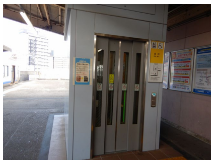
エレベーター
