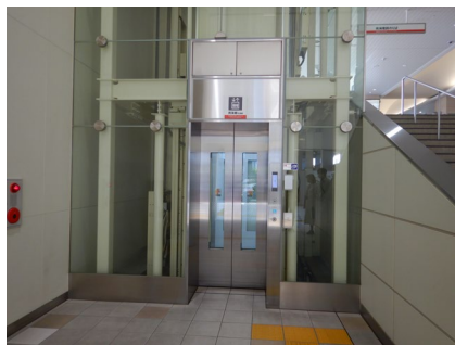
エレベーター
