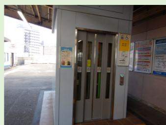
エレベーター
