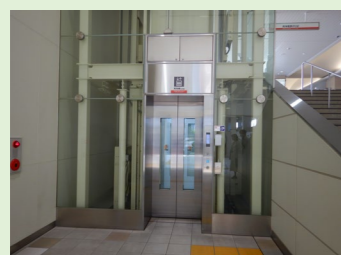
エレベーター
