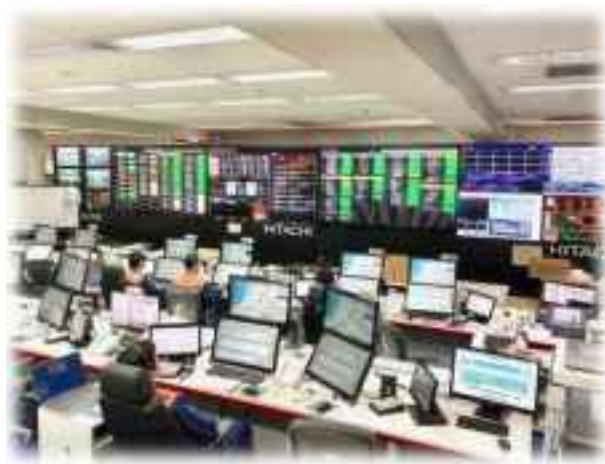
消防指令センター
