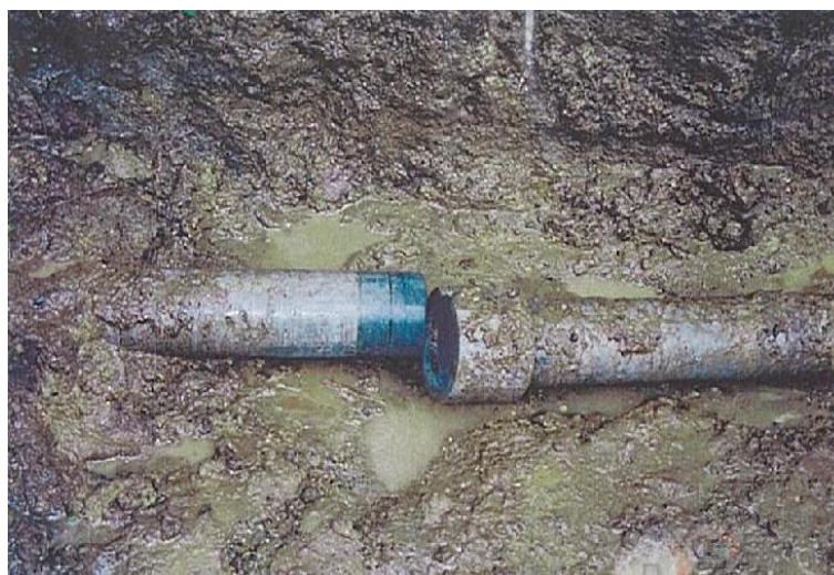
写真 3-2 地震により抜け出した継手部の写真
